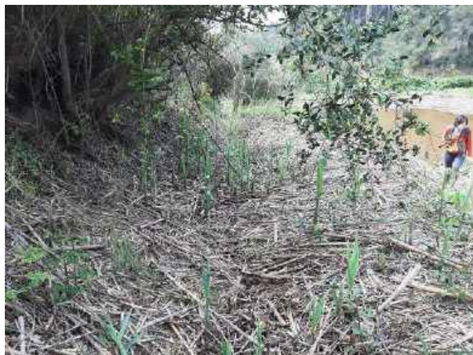
Imatge del canal de derivació colmatat
